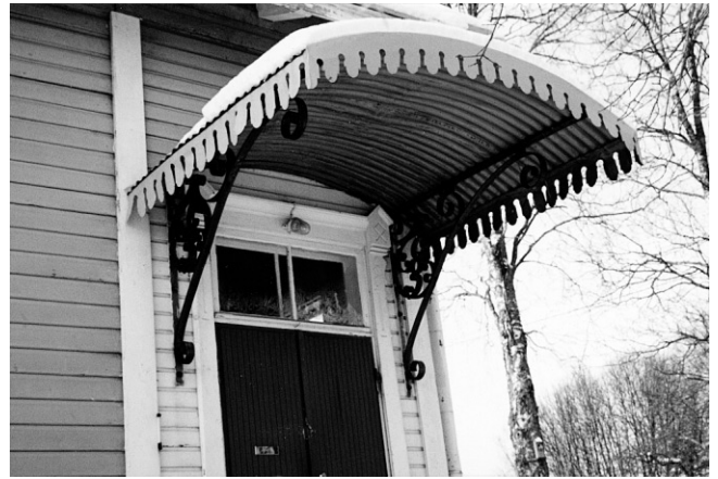
Aaltopeltikatos teräskannakkein. Katolta putoava lumi ja jää on vaurioittanut peltiä. Kaarevan, profiloidun pellin korjaamiseen tarvitaan ammattimestä.
