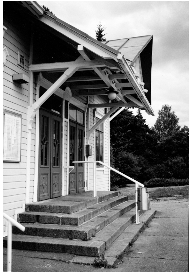
Portaiden yläpuolella on usein katos. Puurakenteinen, peltikatteinen katostyyppi on kestävä kun taas taottujen teräskannakkeiden varassa oleva peltikatos vaurioituu helpommin katolta putoavan jään ja lumen vaikutuksesta.
