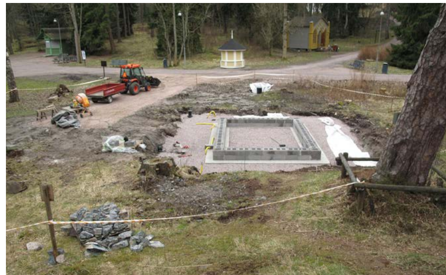
Huvimaja odottaa siirtoa taustalla, kun uusia perustuksia rakennetaan Pikku-Helsingin alueelle Seurasaaren ulkomuseossa. Kuva Anna-Maria Kymäläinen, Museovirasto 2016.
