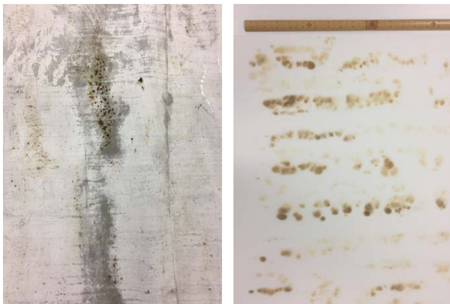
Vasen: Öljymaalin päälle nousseita tummia likapisaroiita tapetin päällemaalausten pinnassa taivasalueella. Kuva Sara Théodore, Museovirasto, 2020. Oikea: Tapettivuodista irronnutta tummaa likaa on imeytynyt vuotien kostutuksessa käytettyyn imupaperiin. Kuva Sara Théodore, Museovirasto, 2020.
