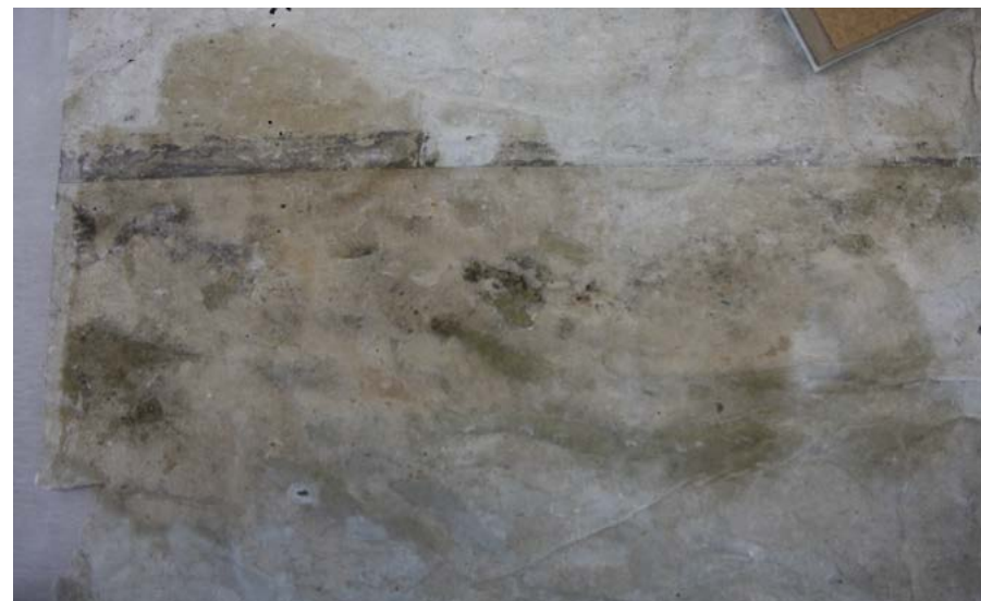
Tapetin vanhojen taustakerrosten alta paljastuu vuotien sauma sekä tummentunut öljytahra ja vanhoja homevaurioita. Kuva Sara Théodore 2019, Museovirasto.
