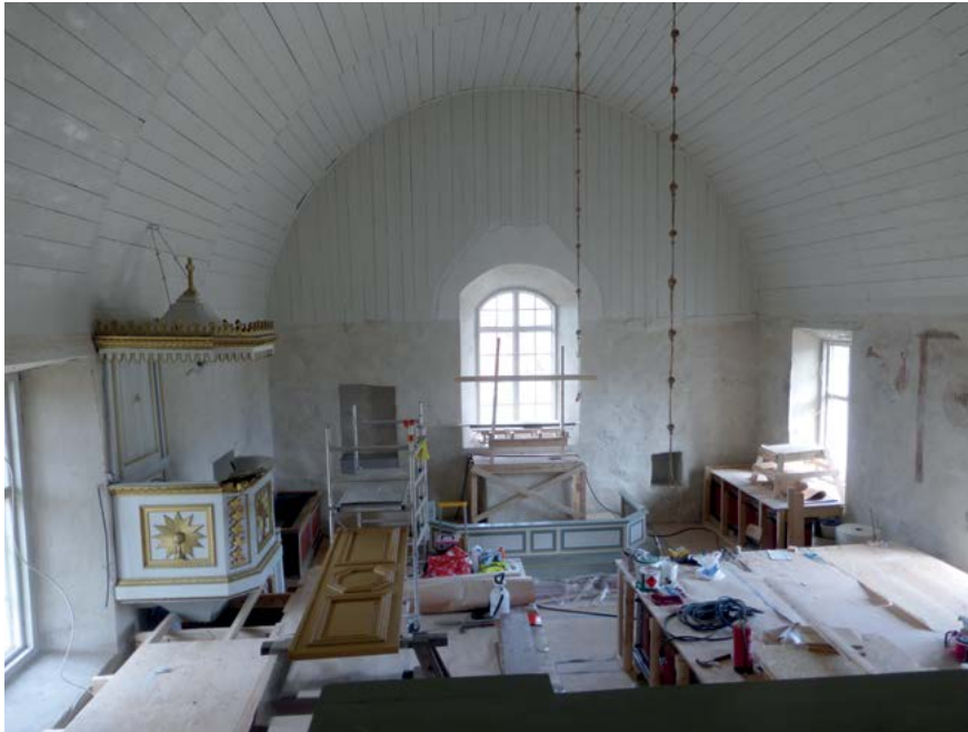
Ahvenanmaan Getan kirkko työmaavaiheessa vuonna 2017. Kirkon penkit ja alttari on suojattu tukevasti korjaustöiden ajaksi.
