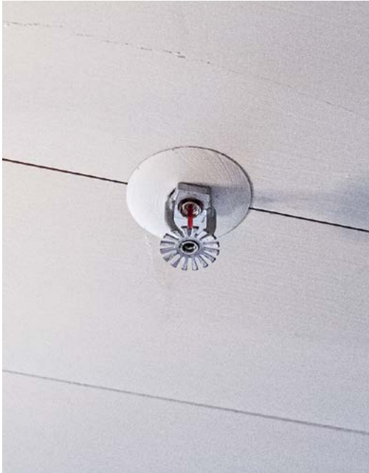
↑ Sprinklerin piilosuutin peitelevyllä lautakatossa.
