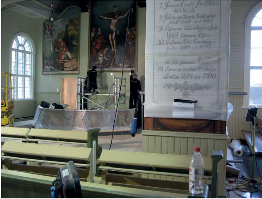
Lohtajan kirkossa ammattilaiset ripustavat alttaritaulua paikoilleen korjauksen jälkeen. Työvaiheiden järjestys on tärkeää.
