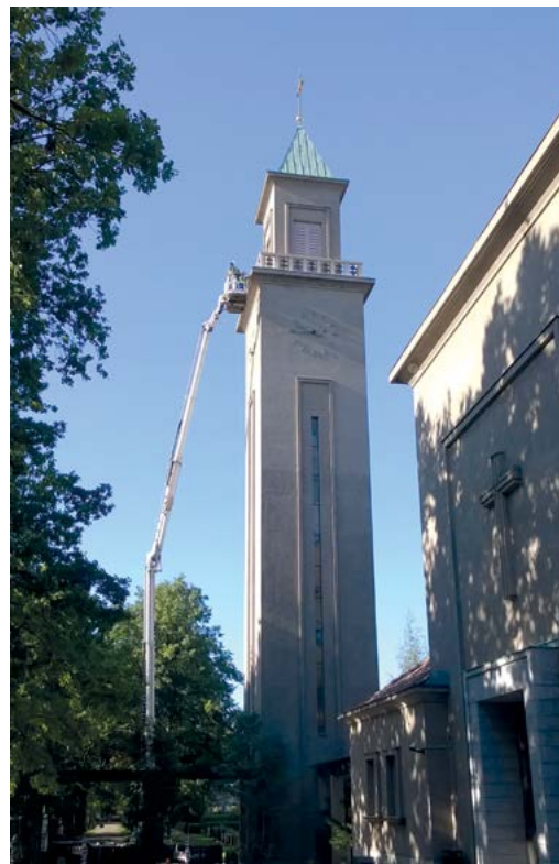
Lagning av puts görs såväl med lyftkranar som på byggnadsställningar under väderskydd. På bildens visas lagningen av putsen på det nya kapellet på Sandudds begravningsplats i Helsingfors 2014.
