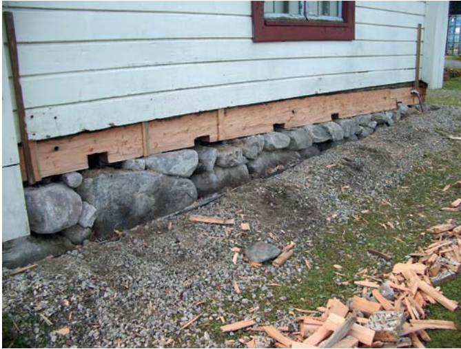
Torneå kyrkas stenfoot. Ventilationen i grunden har försämrats på grund av att markytan stigit. Stenfooten grävdes fram och markytan omformades så att den sluttar bort från byggnaden. Också timmerstommens nederta stock byttes ut.
