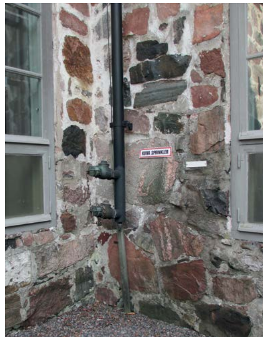
Släckningssystemets matarkoppling för brandkåren. Räddningsverkets enhet hämtar tillägsvatten.
