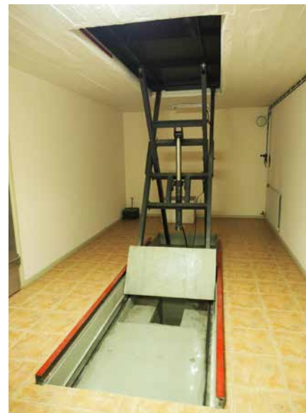
Akaan Toijalan siunauskappelissa vainaja nostetaan arkkuhissillä kellarin kylmätiloista pääkerroksen kappelisaloon.
