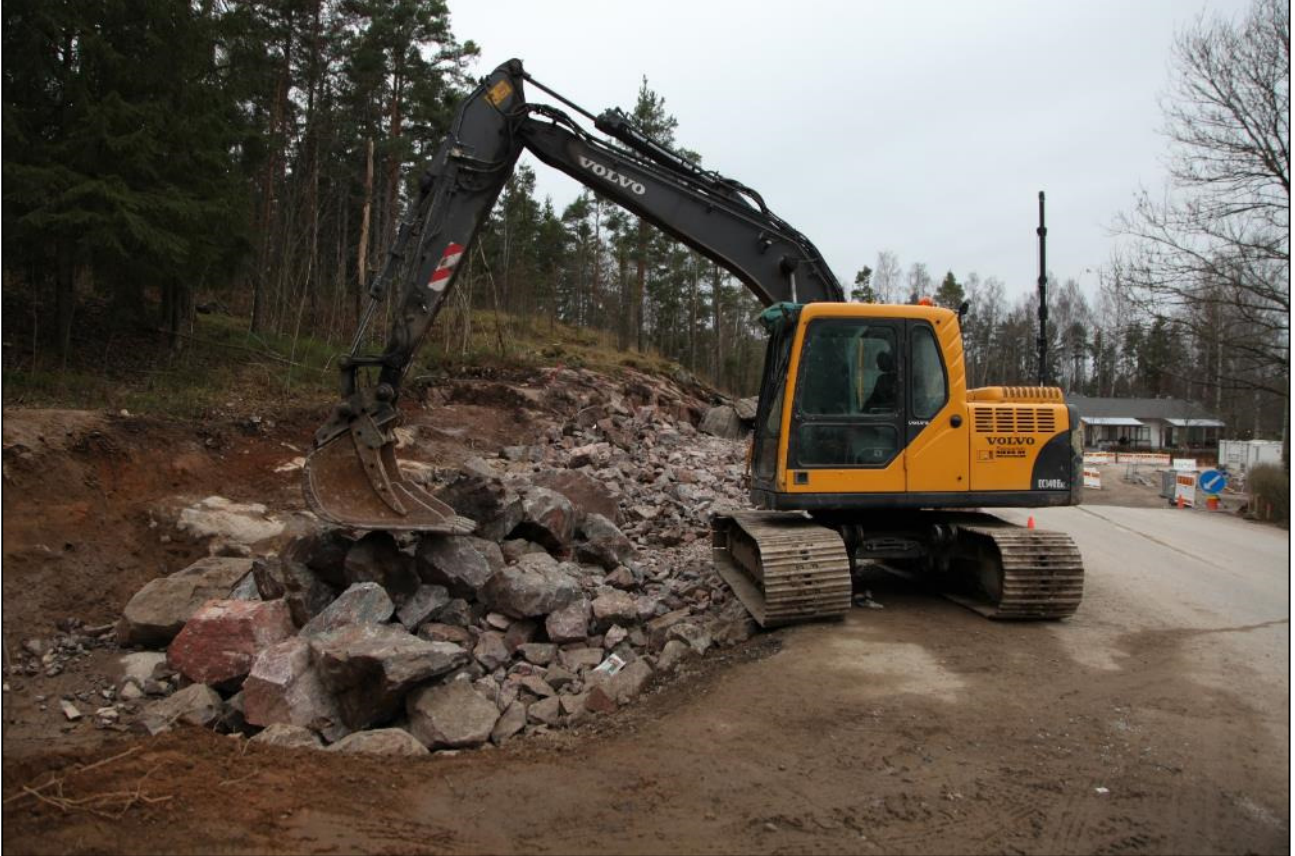
Kalliota louhitaan ja räjäytetään muutaman metrin päässä linnoituslaitteista (Tukikohta XXVIII:18b, Espoo). Kuvaaja: V.-P. Suhonen, Museovirasto.
