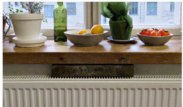
Peltisepäniikkeessä messinkipellistä teetetty haihdutusastia, joka saa käyttövoimansa patterin välityksellä kaukolämmöstä.
