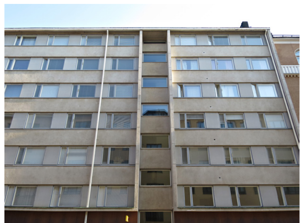
Jos kylmäkomeroiden pienet pyöreät reiät ovat ainoat julkisivuun tehdyt tuloilma-aukot, kuten kuvassa, ilmanvaihto toimii todennäköisesti puutteellisesti.
