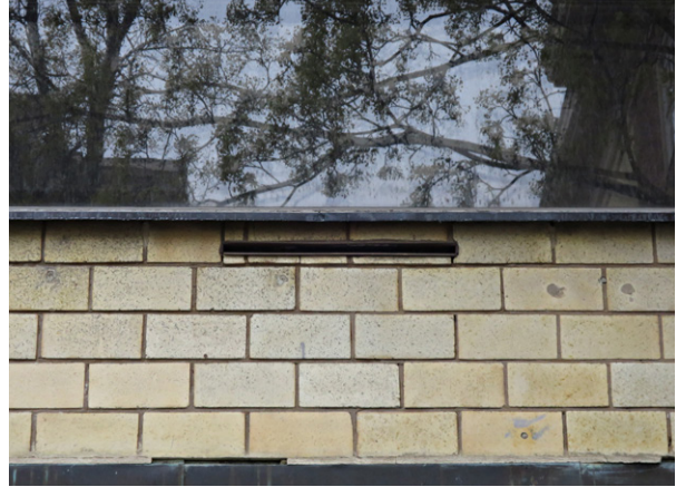
Rakoventtiilin ulkoilma-aukko muuratussa julkisivussa.
