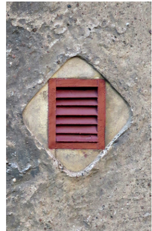
Tuloilma-aukkoon asennettu peltinen ulkosäleikkö, joka suojaa sateelta ja linnuilta.
