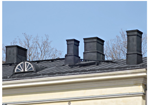
Vasemmalla uusi koneellisen ilmanvaihdon piippu, oikealla vanhoja piippuja. Ainakin osassa rakennusta on koneellinen ilmanvaihto.
