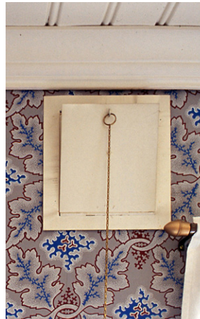
Tuloilmaventtiilinä toimiva kippiventtiili, joka ohjaa tuloilman huoneen yläosaan.
