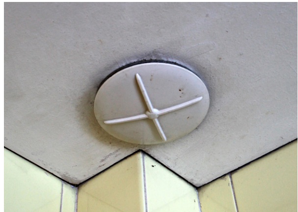
Bakeliittinen lautasventtiili kylpyhuoneen katossa 1960-luvun talossa.
