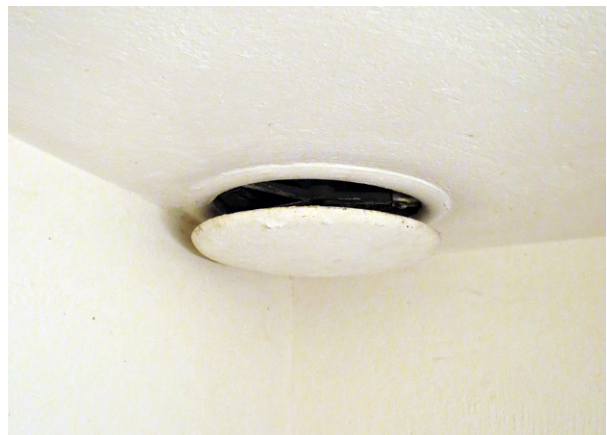
Teräksinen lautasventtiili kylpyhuoneen katossa 1970-luvun talossa.
