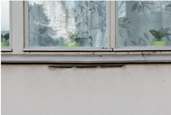
Rakoventtiilin ulkoilma-aukko rapatussa julkisivussa.
