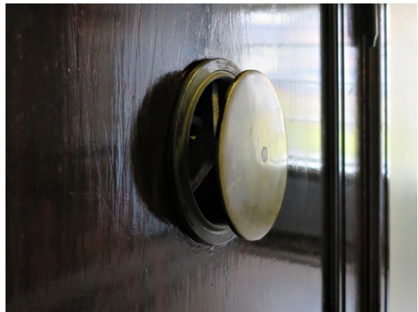
Siirtoilmareitiksi oveen asennettu lautasventtiili.
