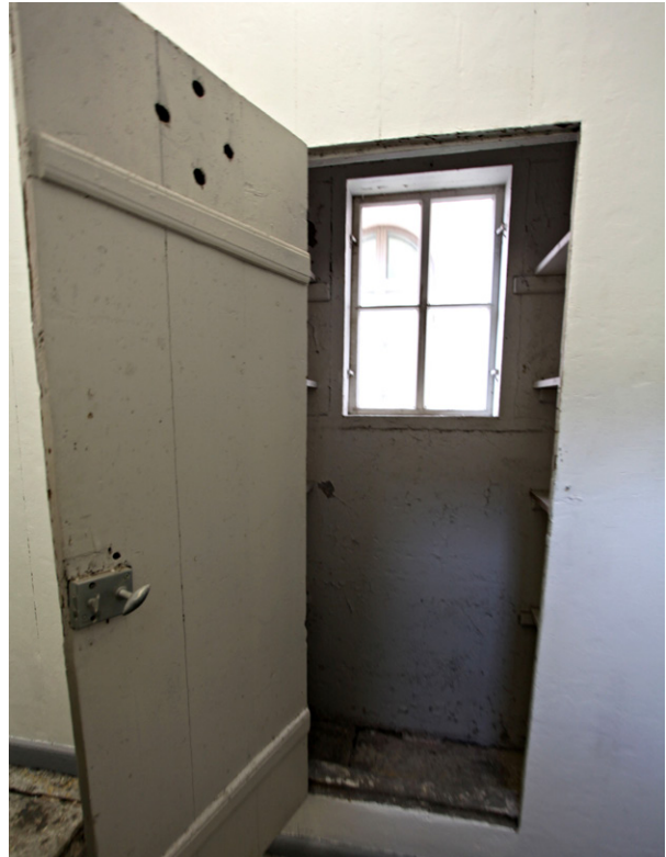
Tuuletusrei'illä varustettu ovi 1860-luvun porrashuoneen kylmäkomerossa. Reiät on sijoitettu oven yläosaan, jotta kylmä ilma ei valu pois komerosta liian sutjakkaasti.
