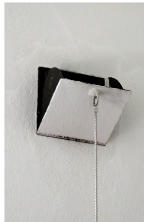
Kippi- eli läppäventtiili, joka toimii tuloilmaventtiilinä. Toisinaan kippiventtiilejä käytettiin myös poistoventtiilinä.
