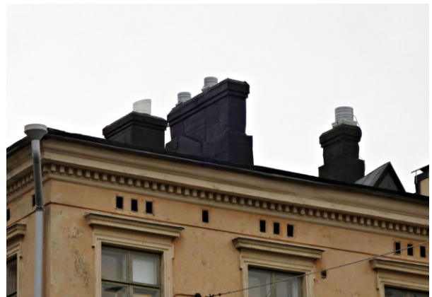
Vanhojen savupiippujen päälle on lisätty sähkökäyttöiset huippumurit. Jos niitä käytetään vain ajoittain, kyseessä on edelleen painovoimainen ilmanvaihto, mutta jos ne ovat jatkuvasti päällä, kyseessä on koneellinen poistoilmanvaihto.
