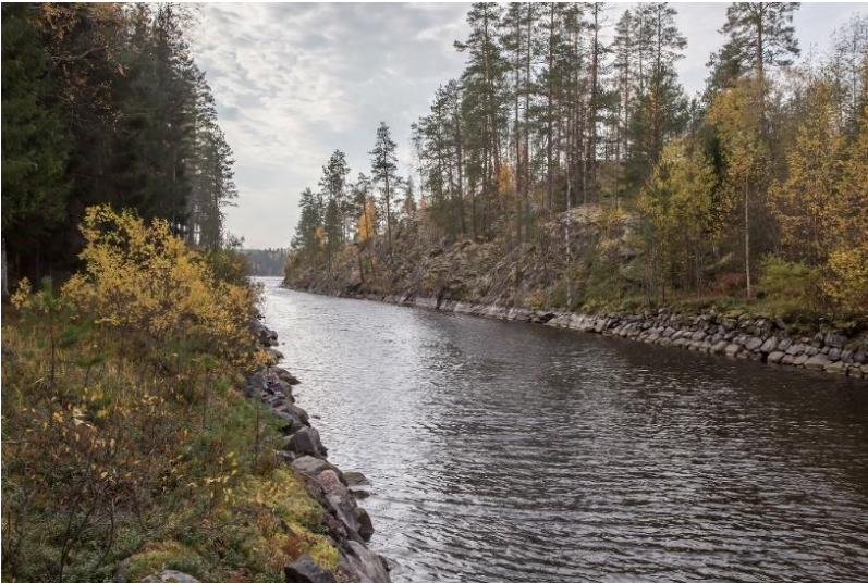
Puumala/Ruokolahti Kukonharjun kanava. 1700-luvun lopulla rakennetun kanavan reunakiveystä. Helena Ranta 2021, AKDG6949:3, Museovirasto.
