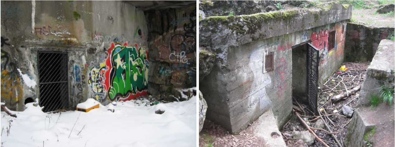
Kuvat 60–61. Lukitukset sekä siivoamisen ja puhdistamisen tarve tarkistetaan riittävän usein erityisesti kaupunki- ja taajama-alueilla olevilla linnoituslaitteilla. Kuvat Päivi Maaranen 2008 ja 2020, Museovirasto.
