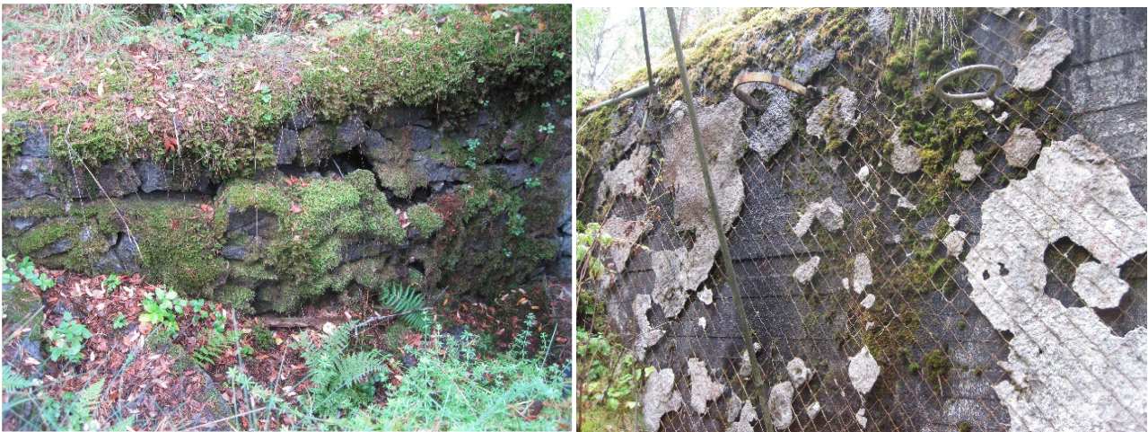
Kuvat 29–30. Kivi- ja betonirakenteiden murtumia voi korjata, jos se on tarpeellista esimerkiksi linnoituslaitteen säilymisen ja turvallisuuden parantamiseksi. Kuvat Päivi Maaranen 2019, Museovirasto.
