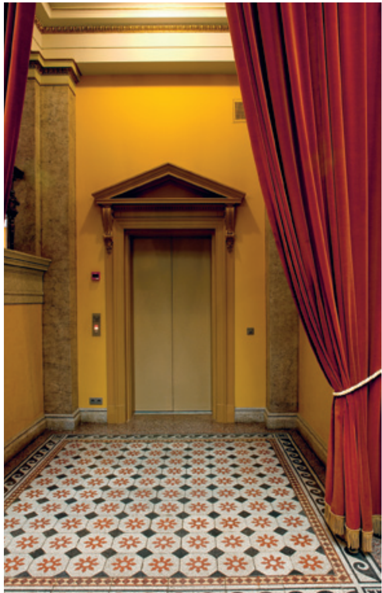
Säätytalon esteettömään reittiin liittyvä hissi sopeutuu arvokkaaseen interiööriin. Kuva Museovirasto / Soile Tirilä.
