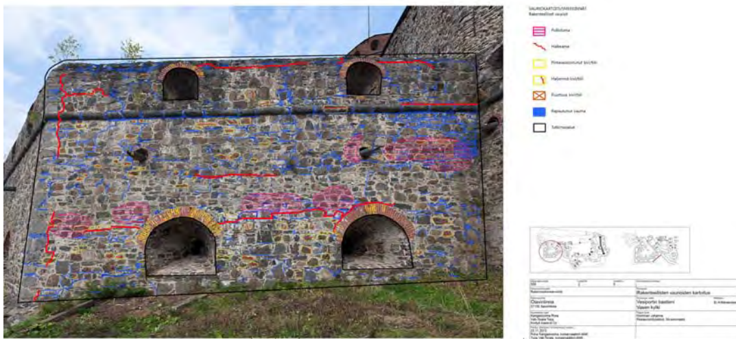
Exempel på skadeinventering. Bilden visar olika skadetyper i Olofsborg. Tuija Väli-Torala och Riina Kangasluoma, Kivityö Kaseva Oy.
