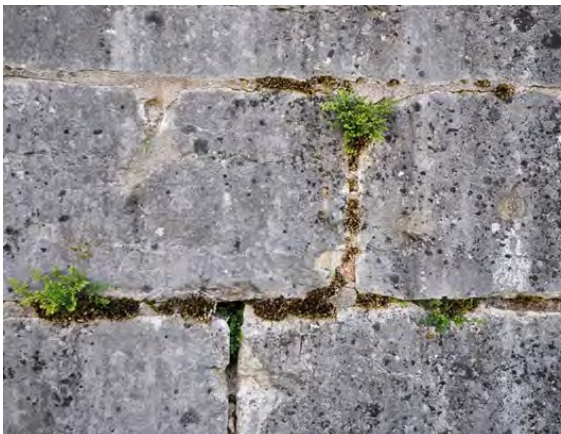
Öppna fogar som inte lagats och som släpper in vatten vilket bidrar till att växter kan etablera sig. Väl underhållna fogar skyddar byggnaden mot fuktskador och sparar på så sätt pengar i det långa loppet. Roma klosterruin. Foto: Helen Simonsson, Riksantikvarieämbetet CC-BY.
