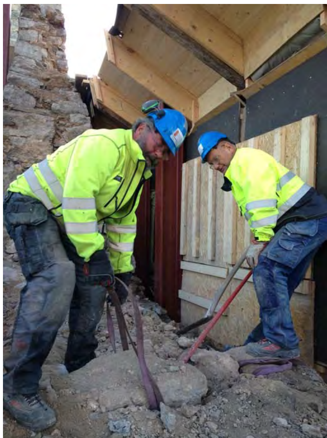
Muren under nerplockning. Stenarna spettades och bändes loss och hissades sedan ner med kran. Materialet sorterades efter var det kom ifrån enligt principen inre skal, yttre skal, fullmur och kärna. Ca 1/3 av stenen kasserades pga. svåra vittringsskador. Ny sten av samma typ hämtades från stenbrott nära Visby. Foto: U.Mebus
