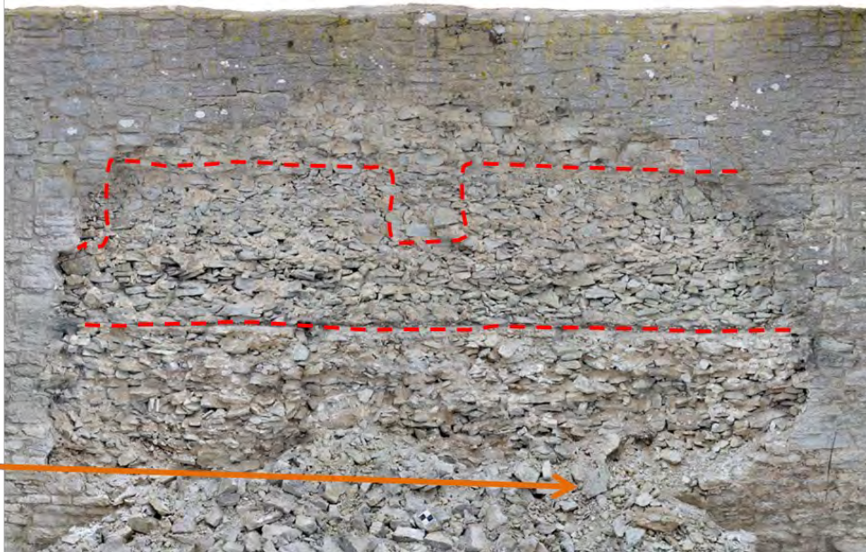
Murens två olika byggnadsfaser framträder tydligt i raset; med den tidigare krenelerade muren samt skyttegången på murens insida. Foto: M.Anglert
