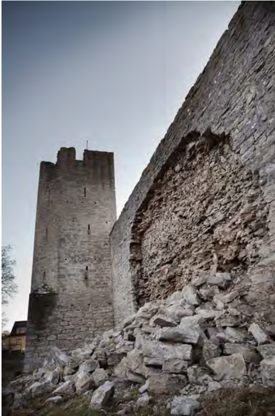
Visby Ringmur rasade 24. februari 2012
