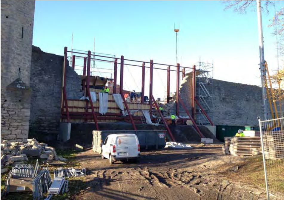
För att staga upp det raserade murpartiet inför en kontrollerad och säker nerplockning byggdes en stålkonstruktion upp omkring raset. Muren fixerades i läge genom att utrymmet mellan ställning och mur fylldes med skumglas. På bilden har nerplockningen avancerat ett bra stycke. Foto: U.Mebus
