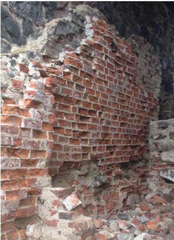
Typiska vittringsskador på tegelmurverk med alltför hårt och tätt fogbruk.
