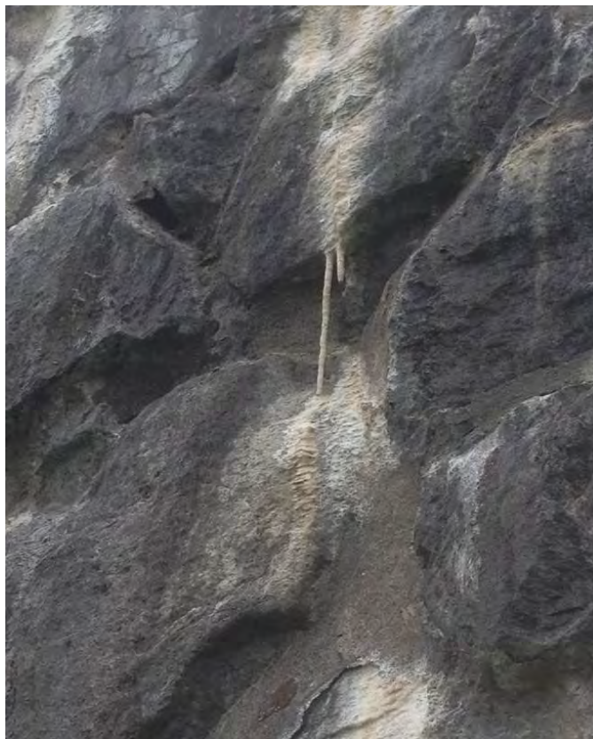
Kalkutfällning med stalaktitbildning på Stegeborgs slottsruin.
