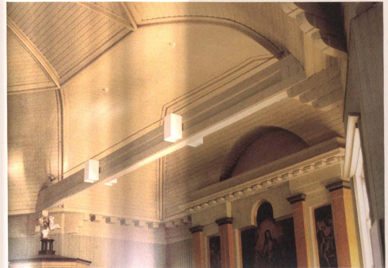
Kirkkosalin sidehirret eivät ole oikea paikka valaisinten sijoittamiseen tai ripustamiseen. Niitä ei myöskään tule upottaa lautaholviin tai sen kantaan. Lisäksi työturvallisuus valaisinten huollossa on syytä ottaa huomioon.
